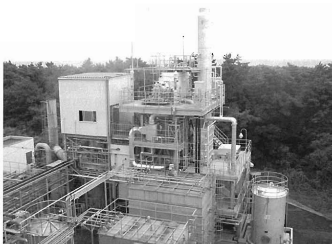
完成した静岡工場2号廃液焼却炉
